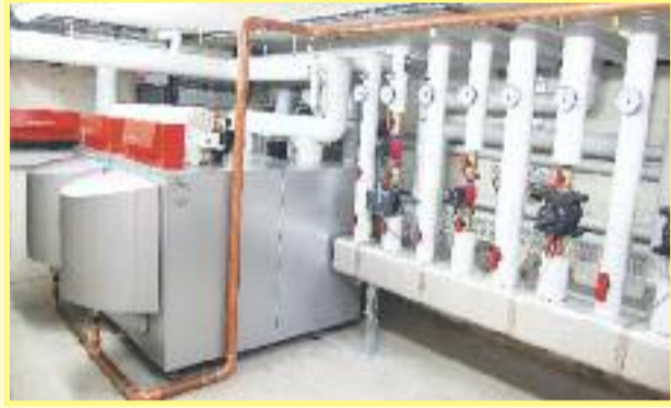
Die Heizzentrale mit Kessel- und Verteileranlage
